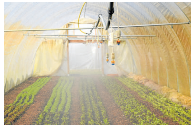
Im Folientunnel läuft die Bewässerungsanlage.
